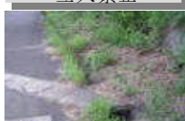
⑥ 梅ヶ丸団地内 側溝蓋なし
