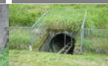
③② 排水路 水路・トンネルへの柵なし
