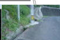
②⑤ 慰霊塔下 側溝蓋なし
