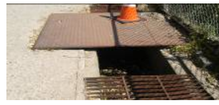
側溝が破損している。
