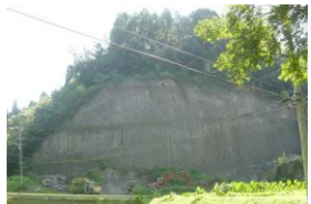
2 崖崩れおそれ
